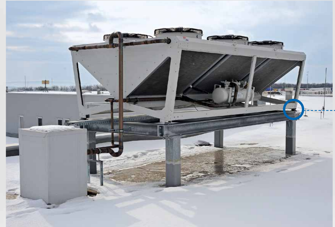
Auf Topfelementen gelagertes Kühlsystem.
